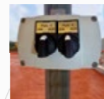
Ein- und Aus-schalter am Platzeingang
